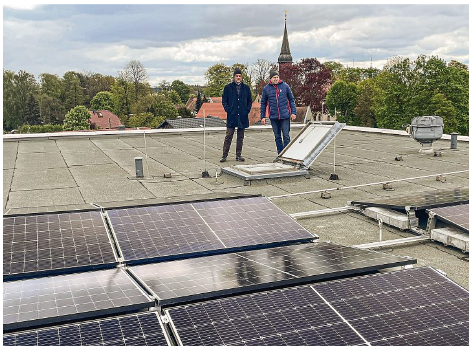
Die Photovoltaik-Anlage auf dem Dach der Oberschule Schönfeld wurde unter anderem mit Mitteln der Klimamillion geschaffen.
