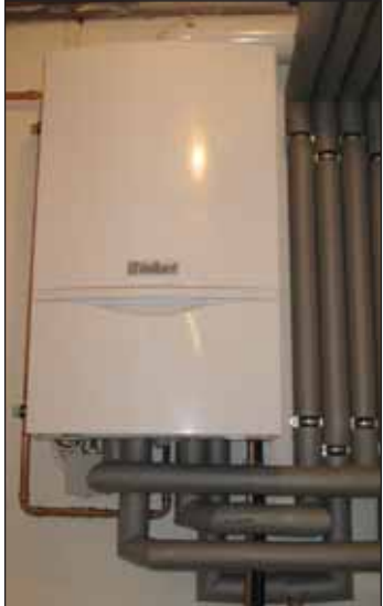
Brennwertgerät, Baujahr 2009 → Gleiche Leistung bei halber Größe
